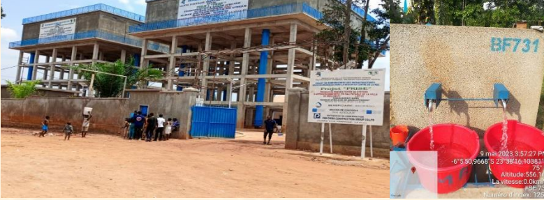
L'Alimentation d'Eau Potable (AEP) de la ville de Mbuji-Mayi.
